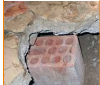
Particolare dei vuoti sotto la pavimentazione.
