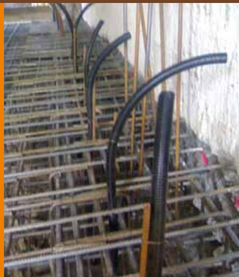
Dopo il getto della nuova trave di fondazione i tubi di plastica saranno rimpiazzati dai tubi d'iniezione.
